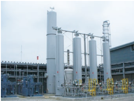
PSA装置 設計圧力: 1.6MPaG 処理量: 1,000m³/h PSA system Design Pressure: 1.6MPaG Processing Capacity: 1,000m³/h
